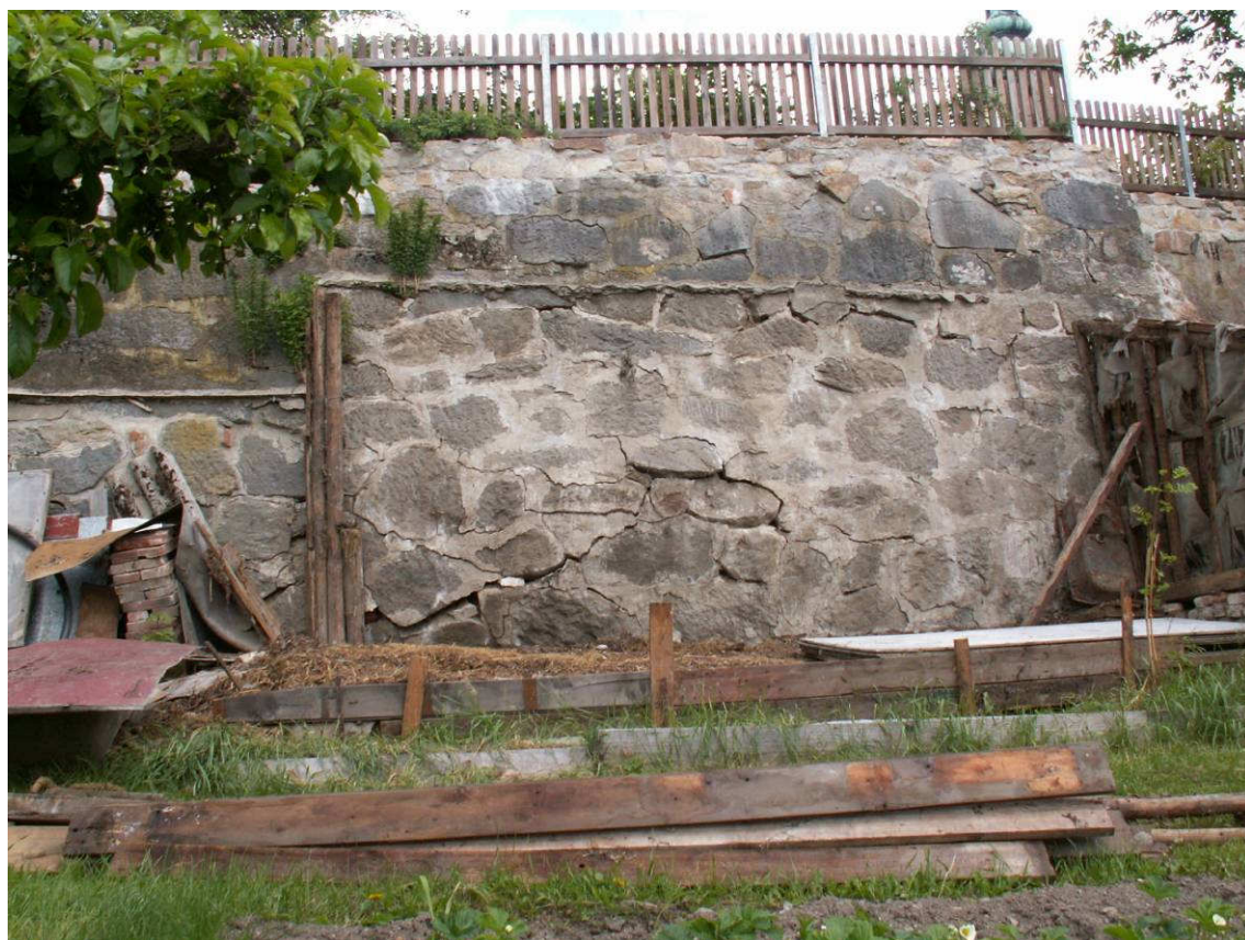
Stav před zřícením
